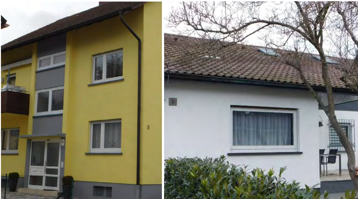
Abbildung 28: Beispiel für Gebäude mit neuen Fenstern und ungedämmter Außenwand
